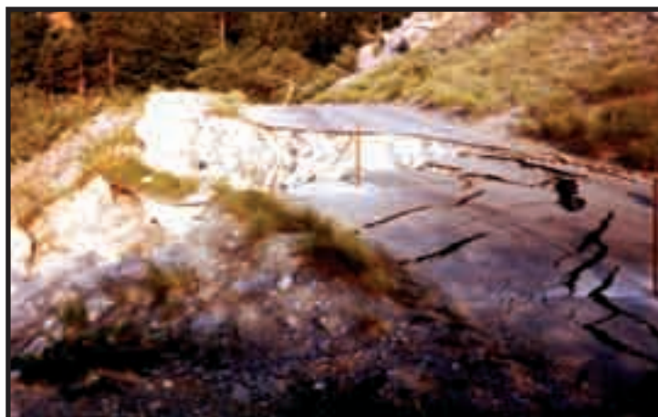
Effondrement de l'ancienne route du lac vert (11 juillet 1983) avant que celle-ci ne soit complètement emportée et détruite par le nant Bordon
